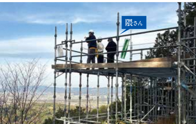
昨年12月23日、展望テラスに設置するサイン(説明板)のデザインを固めるために、工事中の足場を上り、完成時のテラスの高さから京都市内を眺める隈さん
