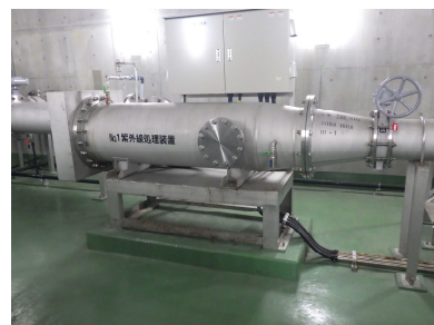
紫外線処理設備
