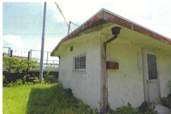
写真：全体的な汚れ・雨だれ（付属棟）
