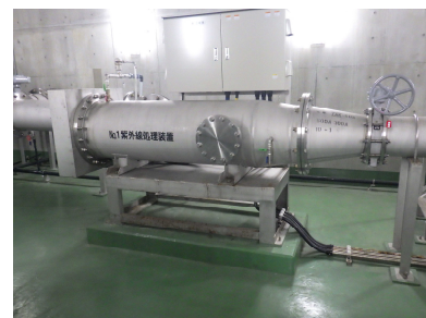
紫外線処理設備
