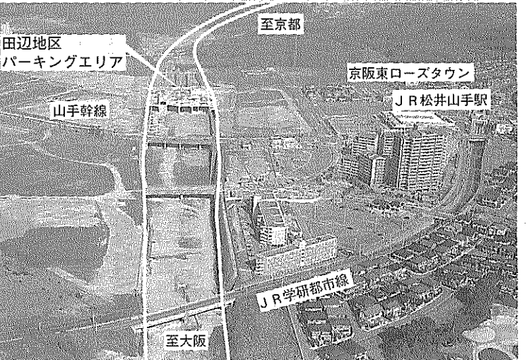
工事が進む田辺地区パーキングエリア付近（今年11月撮影）
