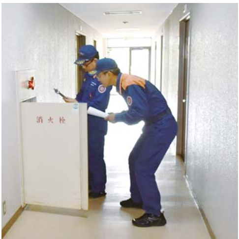
消防職員による査察の様子
