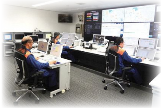
高機能消防指令システム
