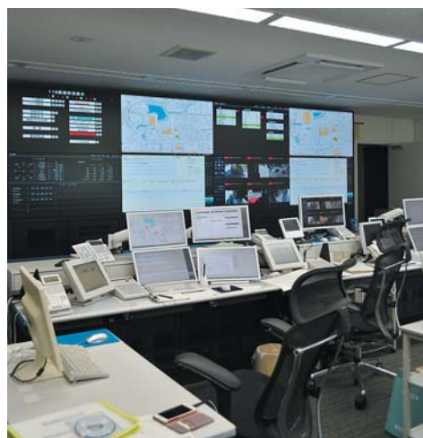
高機能消防指令システム
