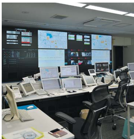
高機能消防指令システム
