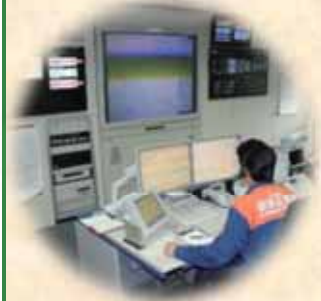
消防活動の要となる 通信指令システム
