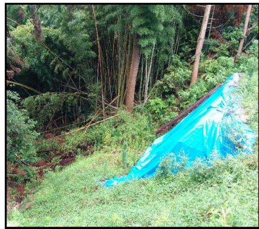
崩落斜面(市道天王高船線)
