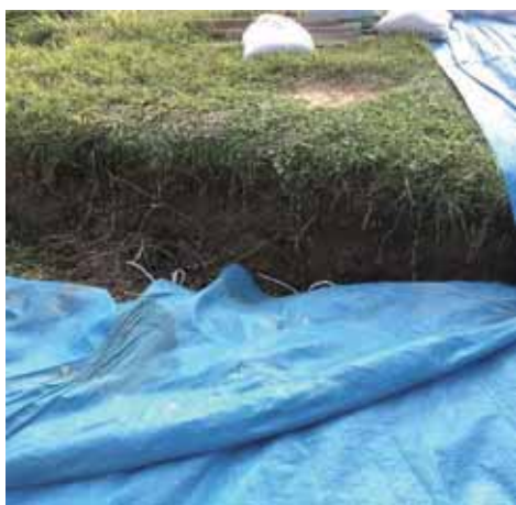
豪雨により沈下した里道(打田地内)
