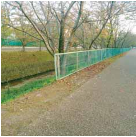
転落防止柵が途中までしかない馬坂川西側歩道
