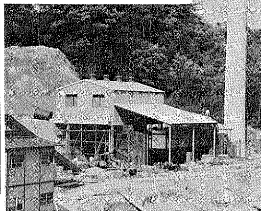
処理能力1日30トンの新しい焼却炉
