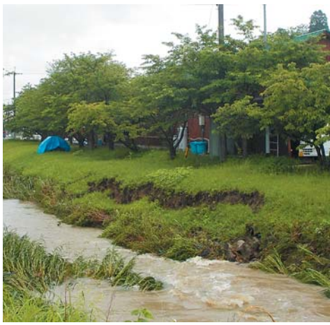
先日の大雨被害で崩れた箇所 (普賢寺ふれあいの駅裏側)
