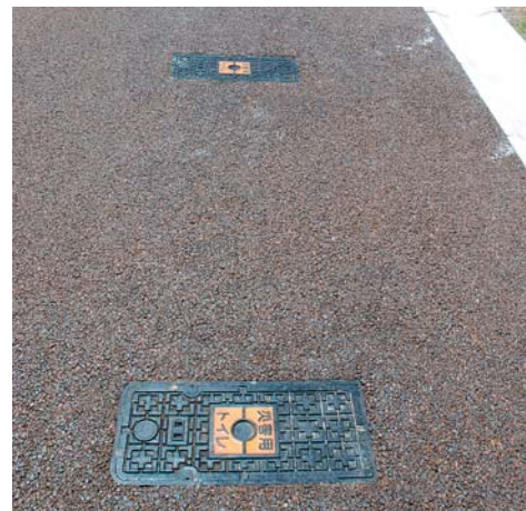
下水管直結のマンホールトイレが整備されている公園(さくらの丘公園)
