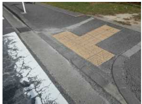
【 横断歩道にわだちができています 】
