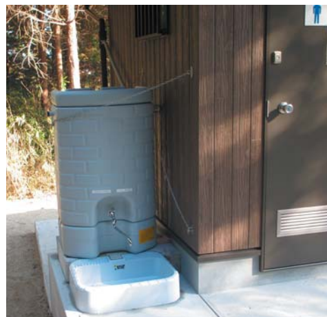
設置された雨水タンク (甘南備山のバイオトイレ)
