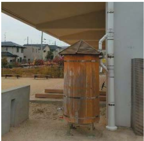
同志社山手北公民館の雨水タンク
