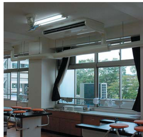
すべての小学校に設置された空調設備
