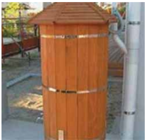
同志社山手北公民館に設置されている雨水タンク
