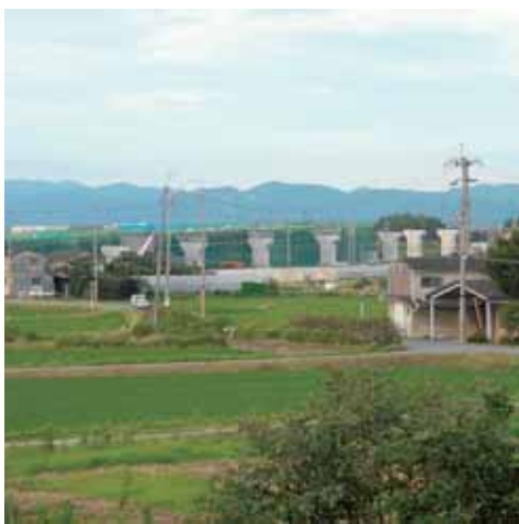
工事が進む新名神高速道路と その付近の大住工業専用地域
