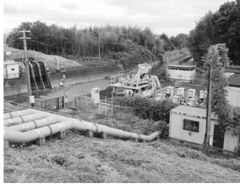
内水氾濫対策にかかせない排水ポンプ (神矢樋門)
