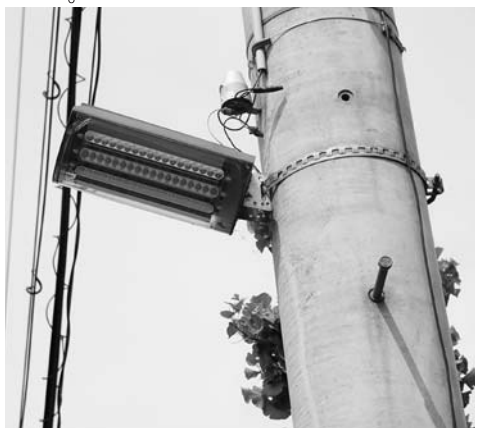
実証実験として設置されたLED防犯灯
