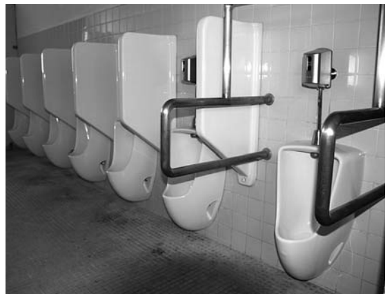
便器の位置を低く改修した低学年用トイレ (草内小学校)
