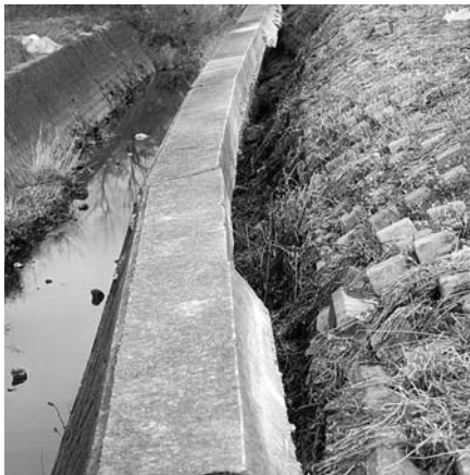
台風18号の豪雨により被害を受けた農業用水路の擁壁
