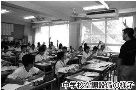
中学校空調設備の様子
