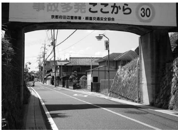
安全対策が望まれている府道八幡木津線 (馬坂川水路橋)
