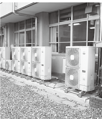
大住中学校に設置された空調機器
