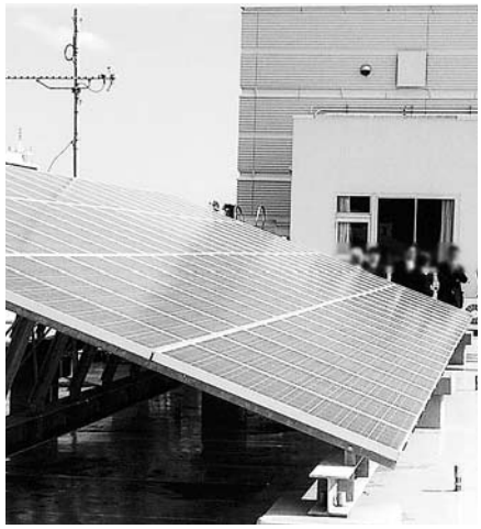
屋上に設置された太陽光パネル
