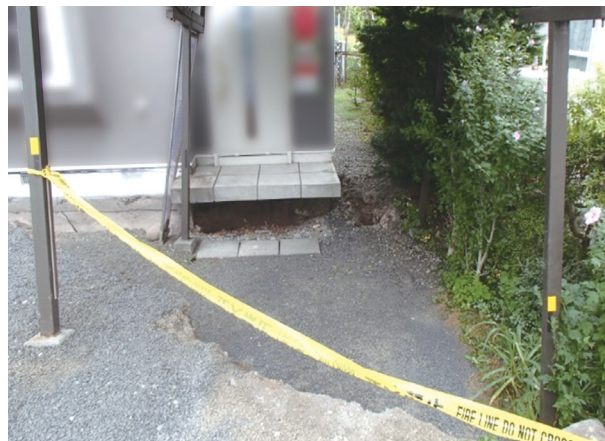
Lún đất xung quanh các tòa nhà (Động đất ở Đông Iburi Hokkaido)
