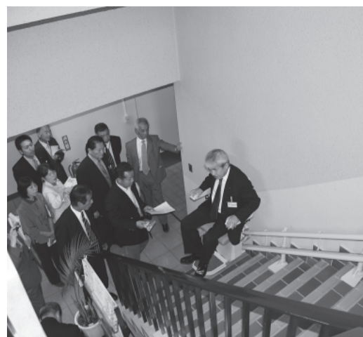
階段昇降機が設置された三山木福祉会館
