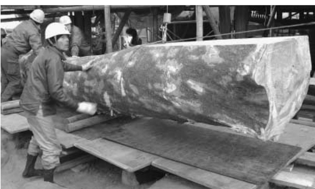
「澤井家住宅」保存修理現場へ運び込まれる重さ3.5トンの天橋立の松(2月1日)
