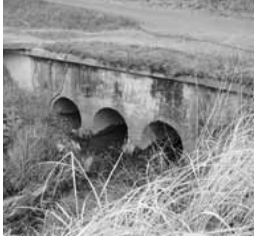
劣化が進む防賀川水路橋
