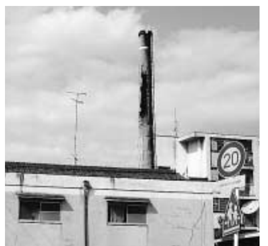
崩壊の危険性がある銭湯の煙突(河原)
