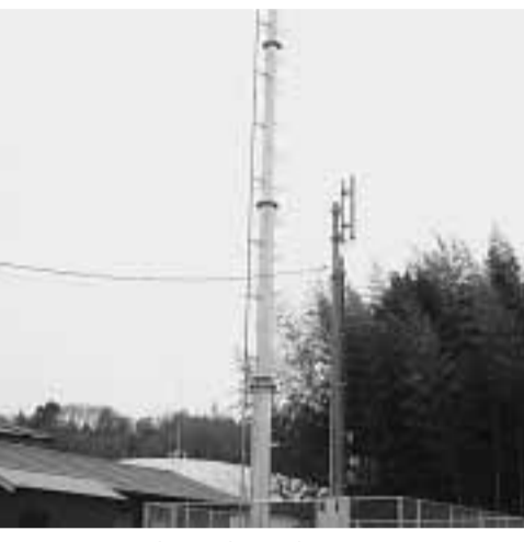
一休ヶ丘地区に建設された携帯電話基地局
