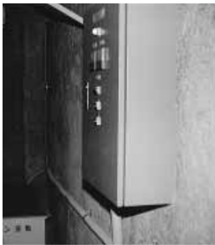
アスベスト使用が判明した中央公民館の機械室
