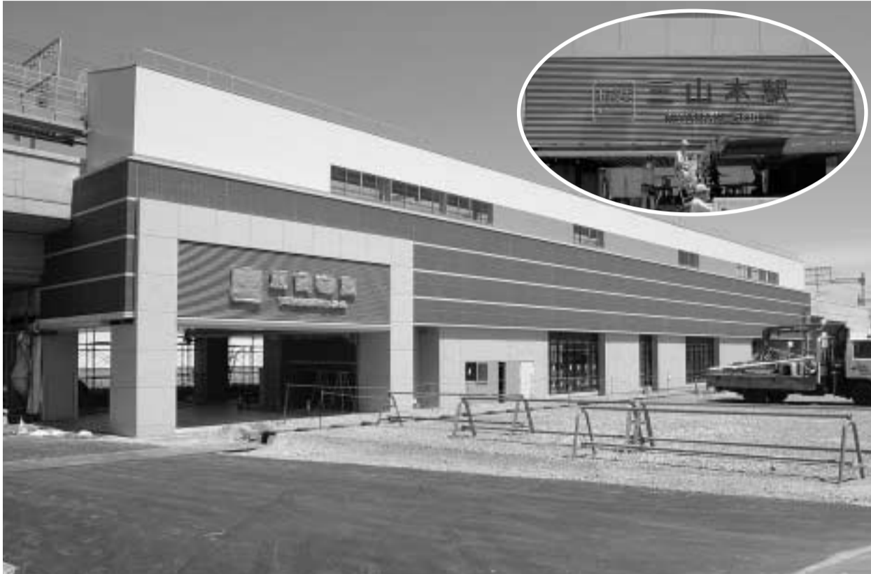
7月10日の開業に向けて工事が進む三山木駅京都方面行き駅舎(6月4日)と駅舎の看板(右)
